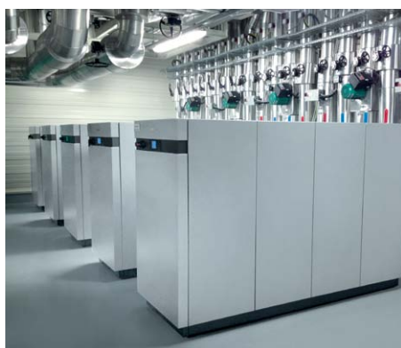
Ciepłownia w zakładzie produkcyjnym w Manisie (Turcja)
